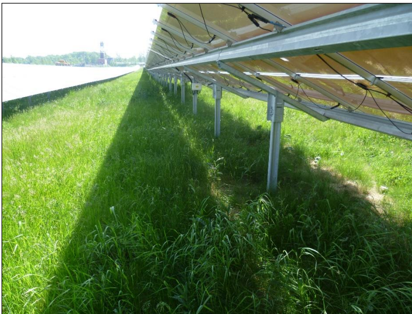
Abbildung 3: Beispiel der Aufständigung von Solarmodulen (in Ronneburg, Thüringen).
