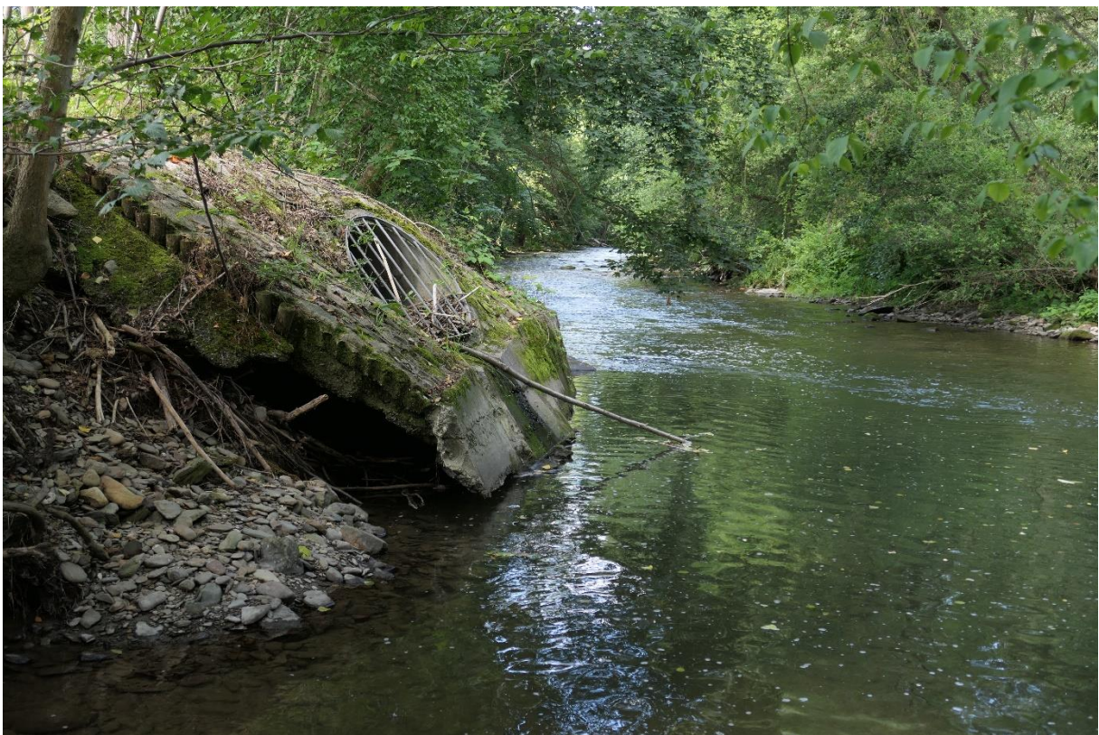
Abb. 9: Unterspültes Einlaufbauwerk – potenzieller Brutplatz für Wasserramsel oder Gebirgsstelze.
