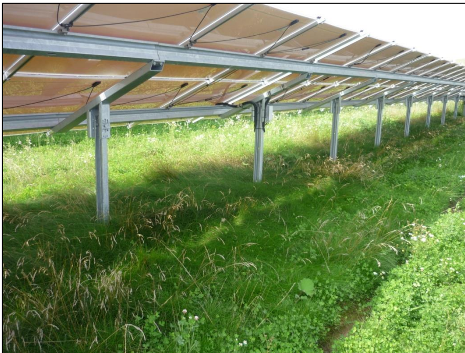
Abbildung 7: Beispiel der Aufständerung von Solarmodulen (Bereich Solarpark Ronneburg Süd). Der Abstand zwischen den Modulen wird so breit gewählt, dass kein Schattenwurf auf die benachbarten Module erfolgt. Die Abstandsflächen aber auch die Flächen unter den Modulen stehen dem Naturhaushalt weiterhin zur Verfügung (Lebensraum, Versickerung etc.).
